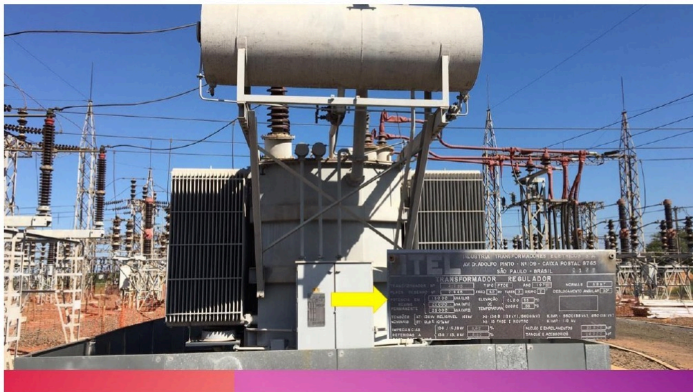
Foto 2 – Transformador/regulador de tensão que alimenta a UC do segurado
