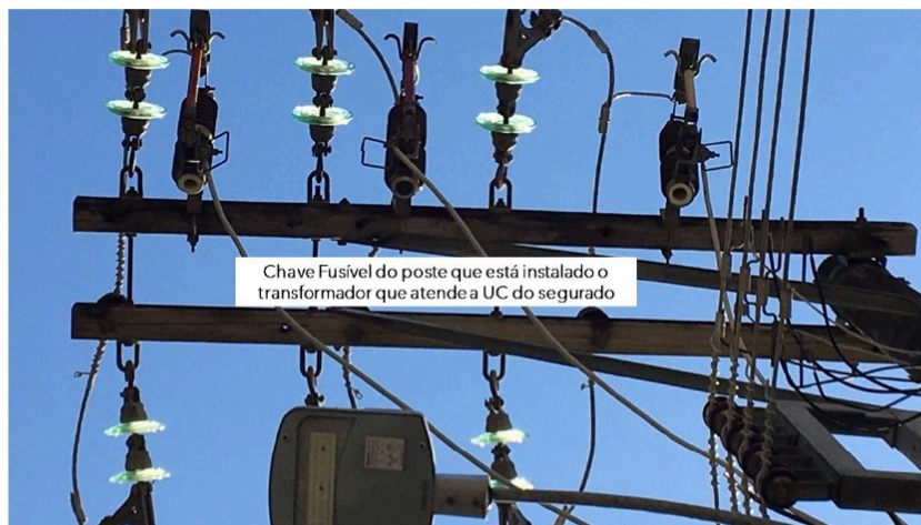
Foto 3 – Chave Fusível do circuito que alimenta a UC do segurado
