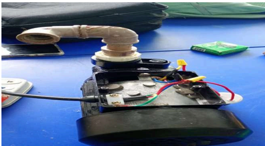
Figura 21 - Teste de capacitor da bomba 1/2 hp.
