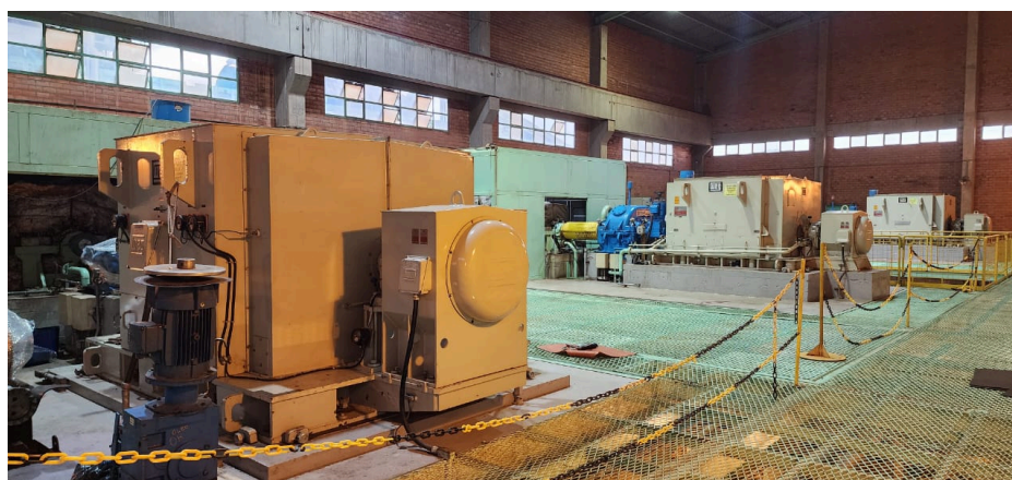
Figura 7 – Geradores de energia elétrica
